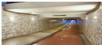
referentie verlichting van het plafond
