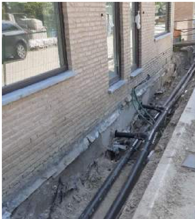
Figuur 17: Aansluiting van het warmtenet van IVBO in de wijk Duivekeet.
